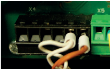
Anschlussklemme X4 Lichtschranke
